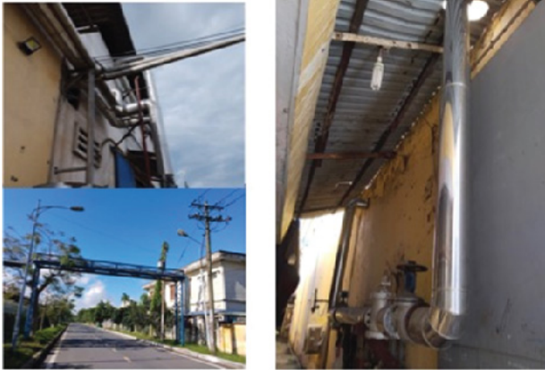
Hệ thống đường ống phân phối hơi giữa 3 công ty từ hệ thống lò hơi tập trung
